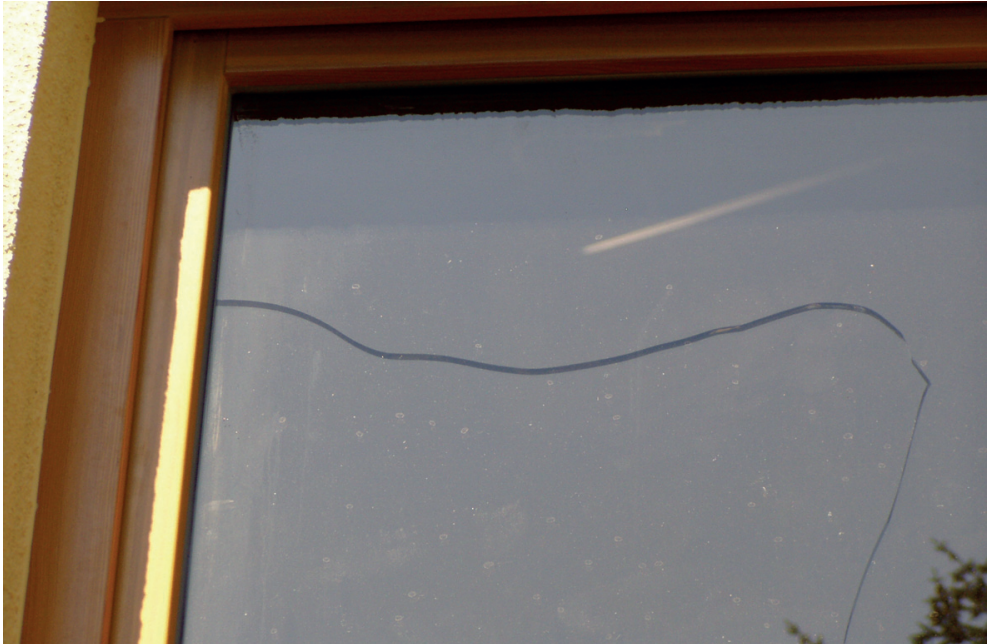
Thermischer Bruch an eingefärbtem, absorbierendem Glas, Bruchverlauf entlang der Kalt-/Warmzone.
