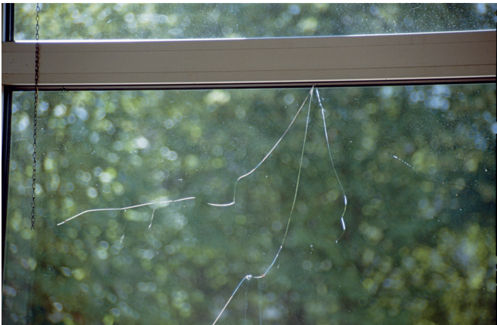
Starker thermischer Bruch verursacht durch direkt an der Innenscheibe aufgehängtes Werbeplakat.
