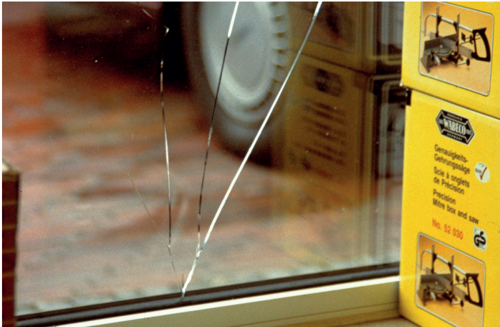
Thermischer Bruch einer Schaufensterscheibe durch direkt an der Scheibe gestapelte Kartons verursacht.
